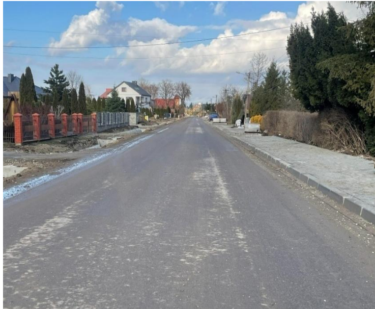
Fot. 41 Droga powiatowa nr 1424K Bochnia – Uście Solne – Barczków w miejscowościach Słomka i Gawłów w trakcie rozbudowy
