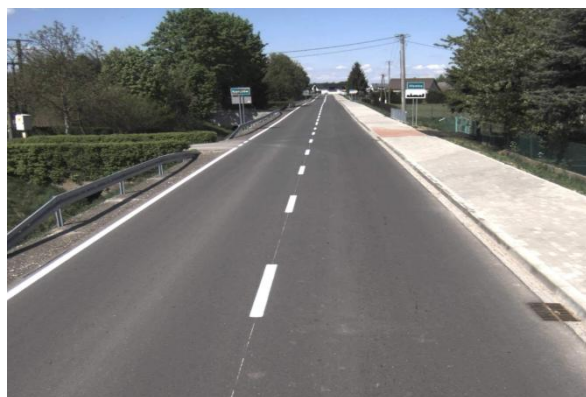
Fot. 51 Odcinek drogi powiatowej nr 1424K w trakcie rozbudowy drogi w miejscowości Słomka
