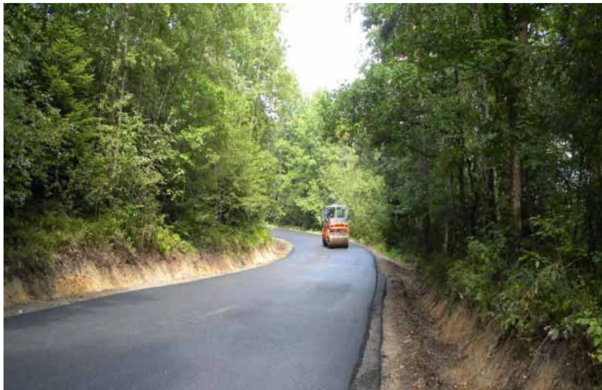
Remont drogi powiatowej nr 1446K Muchówka-Porąbka Iwkowska w km. 0+200 – 2+30 – w trakcie wykonywania.
