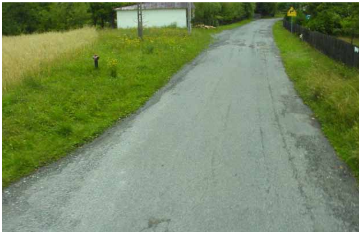
Remont drogi powiatowej nr 2084K Sobolów Zwada w msc. Sobolów/Zonia w km. 2+105 – 2+795 - przed wykonywaniem
