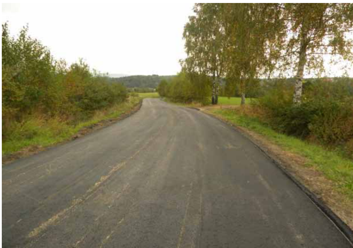
Remont drogi powiatowej nr 2079K Nowy Wiśnicz – Chronów msc. Łomna w km. 2+900 – 3+580 – w trakcie wykonywania
