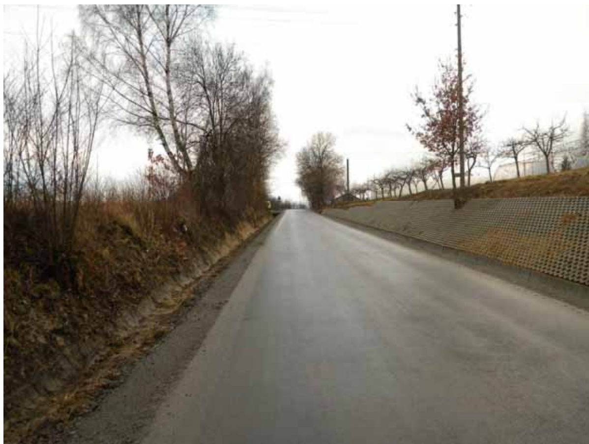
Remont drogi powiatowej nr 2082K Olchawa – Leszczyna w msc. Królówka w km. 5+335 – 5+800 po wykonaniu
