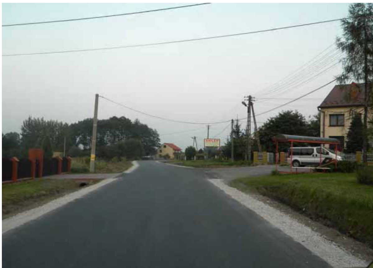
Remont drogi powiatowej nr 2090K Ostrów Królewski – Borek w km 3+300 – 3+600 w msc. Borek - po wykonaniu.
