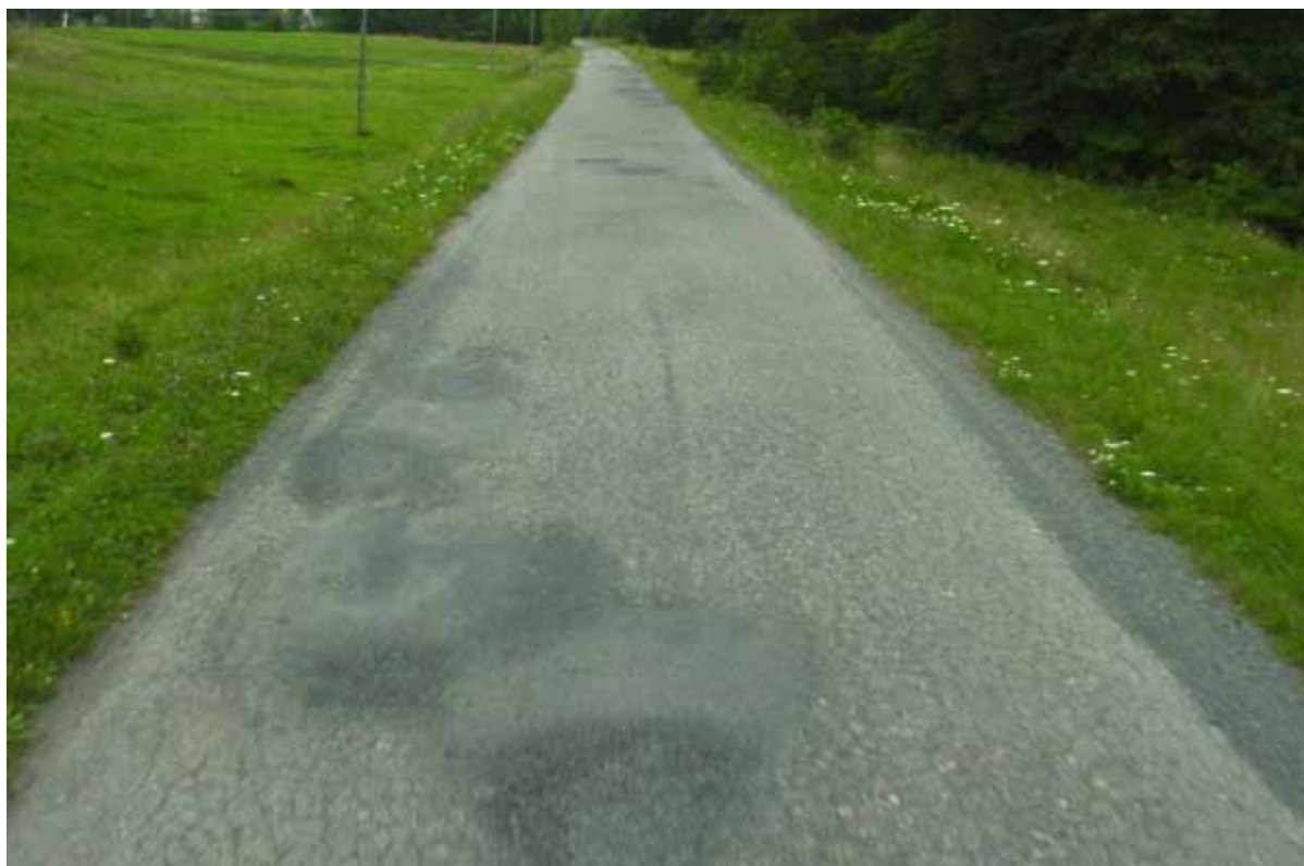
Remont drogi powiatowej nr 2078K Kobyle – Lipnica Górna w km. 3+087 – 3+287 - przed wykonywaniem.
