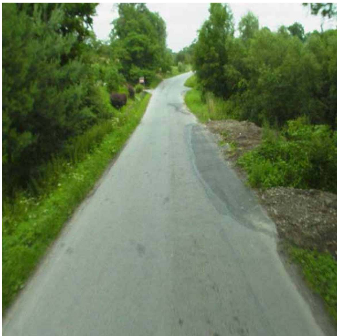
Droga powiatowa nr 1447 K, km 5+460, lokalizacja osuwiska: Rajbrot
