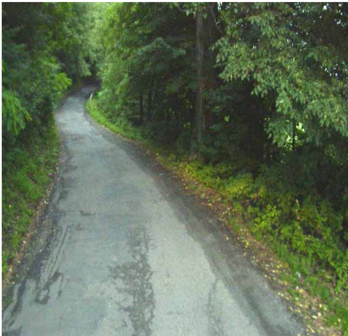
Droga powiatowa nr 2071 K, km 5+840, lokalizacja osuwiska: Ujazd I
