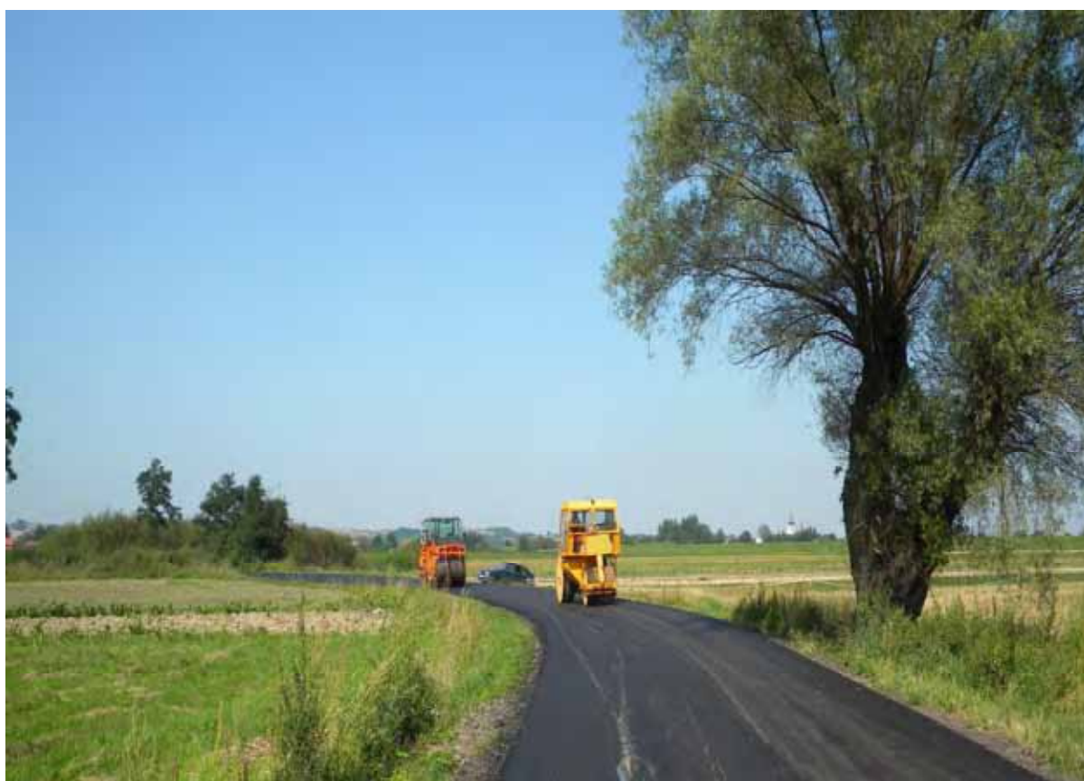
Remont drogi powiatowej nr 2096K Niedary – Gawłówek w km. 1+600 – 1+800 w trakcie wykonywania.
