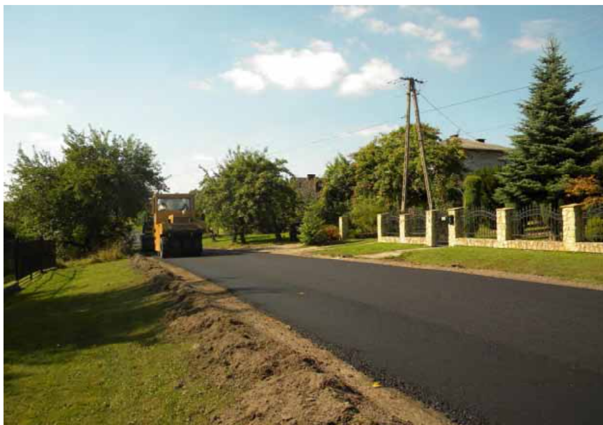
Remont drogi powiatowej nr 2076K Połom Duży- Lipnica Murowana w msc. Połom /Lipnica Górna w km. 3+900 – 4+735 – w trakcie wykonywania.
